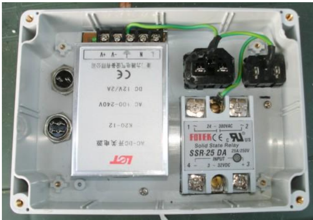
The earth wiring
